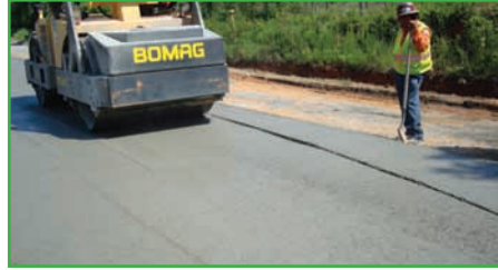
Sıkıştırma sonrası yüzeyde dalgalanmalar
