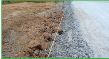
Kenar farklılıklarındaki problemler
